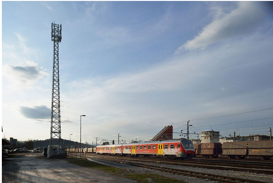
Figura 17. Antena GSM-R (Global System for Mobile-Railway). Fuente: Fotografía tomada de Fasmetrics (2018).
